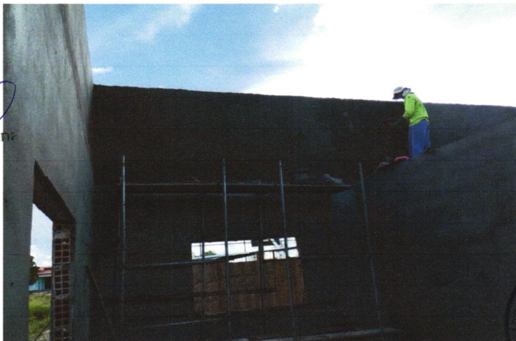
FOTO 16 - MASSA ÚNICA, PARA RECEBIMENTO DE PINTURA, EM ARGAMASSA TRAÇO 1:2:8, PREPARO MANUAL, APLICADA MANUALMENTE EM FACES INTERNAS DE PAREDES, ESPESSURA DE 10MM, COM EXECUÇÃO DE TALISCAS. AF_06/2014
